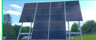
Vermont, EE. UU. Sistemas solares residenciales sin conexión a la red
